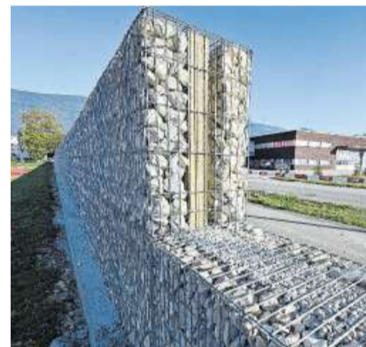
Die Lärmschutzwand ist aus vierlagigen Steinkörben zusammengesetzt: aussen Stein, innen Glaswolle und Kiesbeton.
